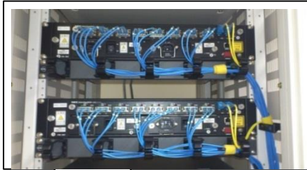
写真 1 3 波長多重化装置 (NEC 社製 Metro Giga 8000)
