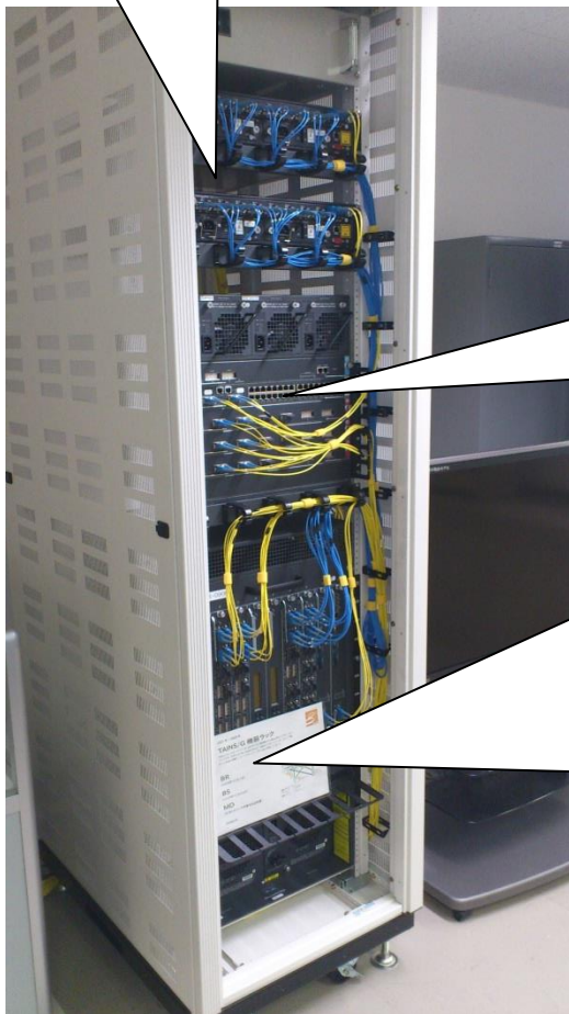
写真 1 2 19 インチラック
